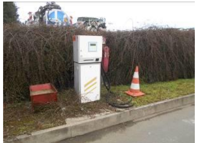
Poste de distribution GO
